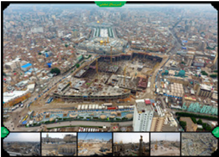
ساخت طرح توسعه حرم مطهر امام حسین علیه السلام صحن و شبستان حضرت زینب علیها السلام کربلای معلی
